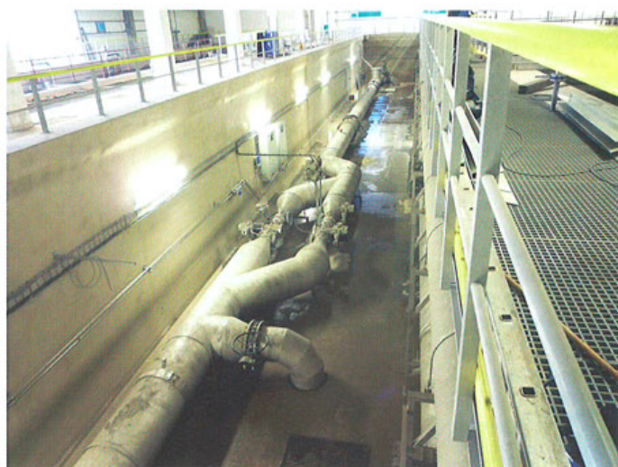
Sběrné potrubí s instalovanými ultrafialovými zářiči
